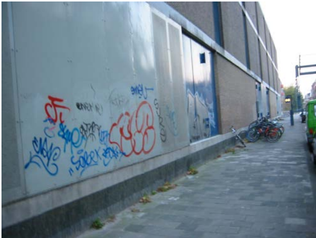
Hoogte Kadijk: zulke wanden lokken graffiti
